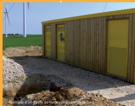
Exemple d'un poste de livraison en bardage bois
